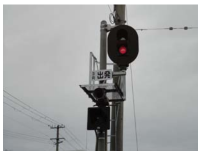
連動装置の改良(継電連動機)
